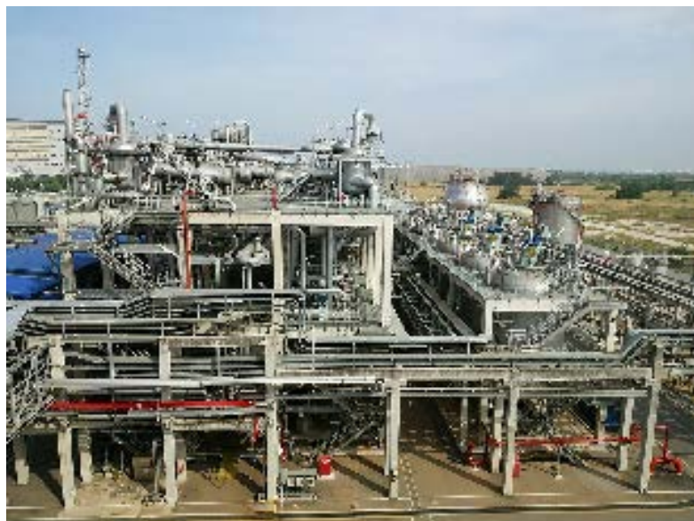
2016年4月よりシンガポールの第二プラントが稼働
