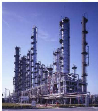
既存のイソプレン抽出プラント（水島工場）
