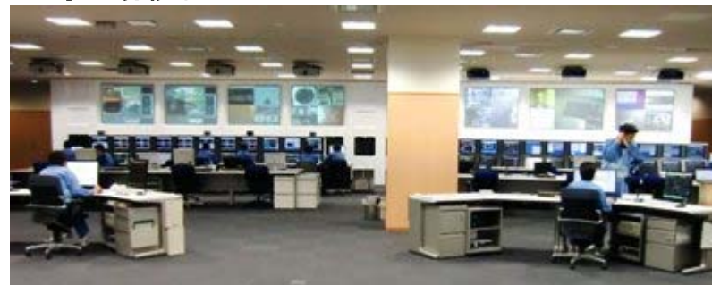
水島工場統合コントロール室内
