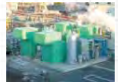
川崎工場の コージェネレーション設備
