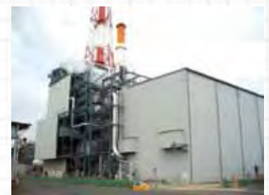
共同ボイラー設備
