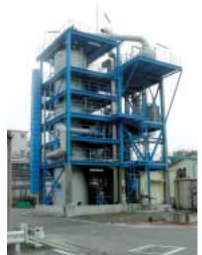
アクリロニトリル回収設備
