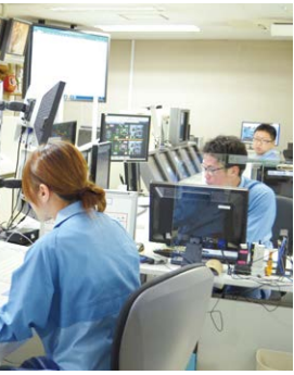
中央コントロール室
