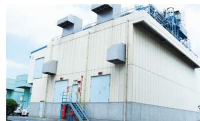
コージェネレーションシステム
