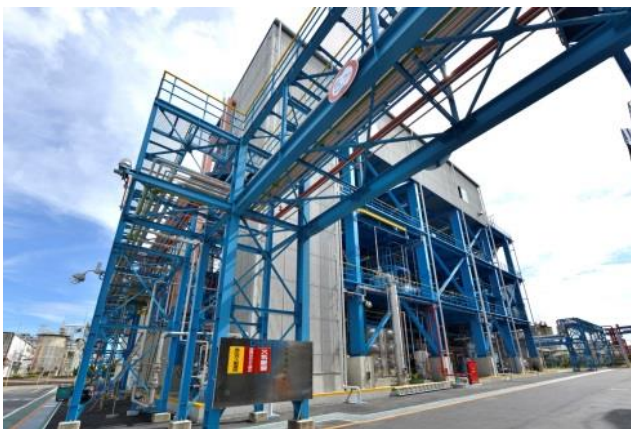
Zetpol ® 製造プラント（川崎工場）
