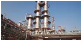
GPBプラント
