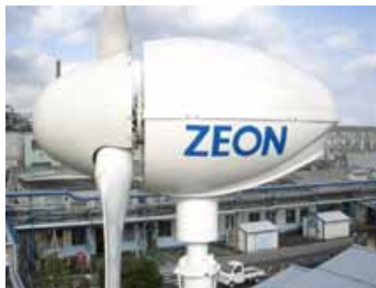
風力発電設備完成(05/8)
