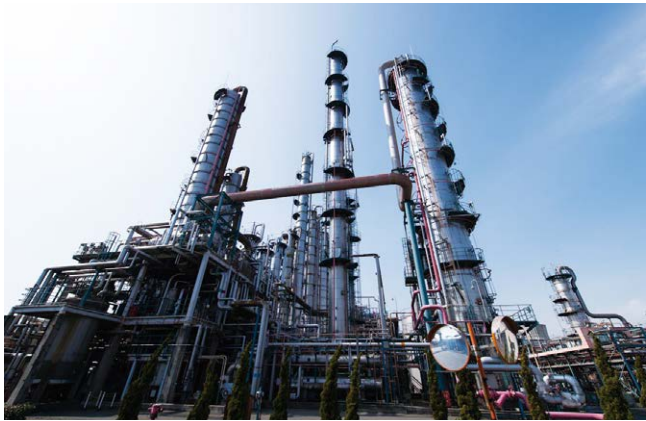
水島工場 GPI プラント
