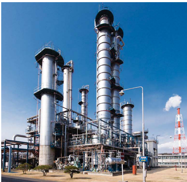
GPBプラント
