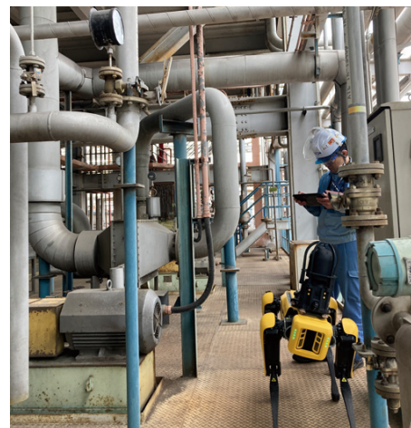
実際のプラントでの巡視検証の様子
